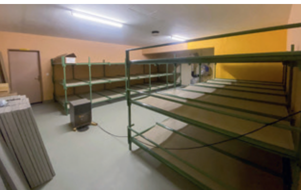
Die Panzertüre, ein funktionierender Luftfilter sowie Liegestellen und Trockenklosett sind zentrale Elemente eines Schutzraums. (Foto: Lara Zürrer)
