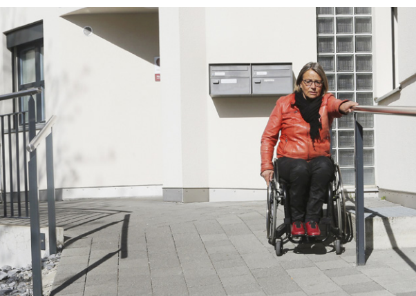
Diese Rampe ist ungeeignet für Rollstühle.
