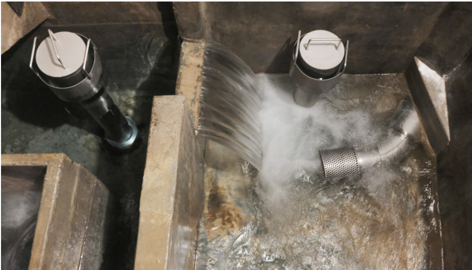
Das Walder Gemeindegebiet umfasst 16 Reservoirs, 33 Quellschächte und 718 Hydranten. Im Bild der Sagenrain-Stollen. Foto: zVg
